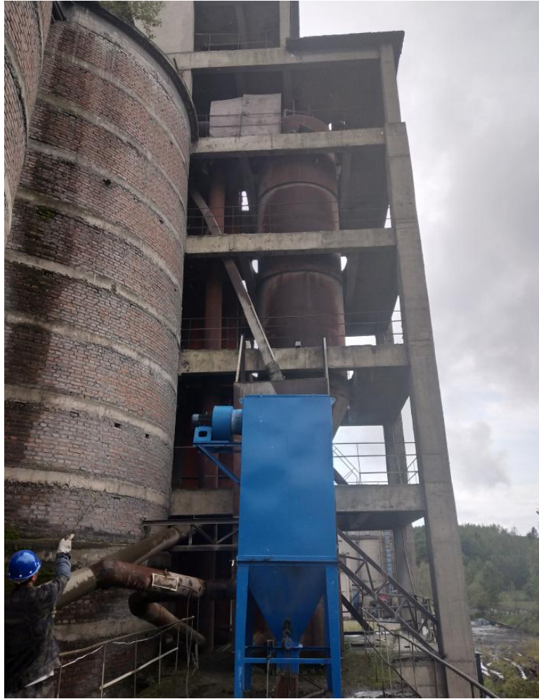
料仓处除尘装置
