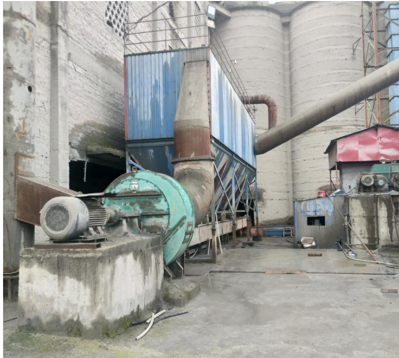
粉磨工段处除尘装置
