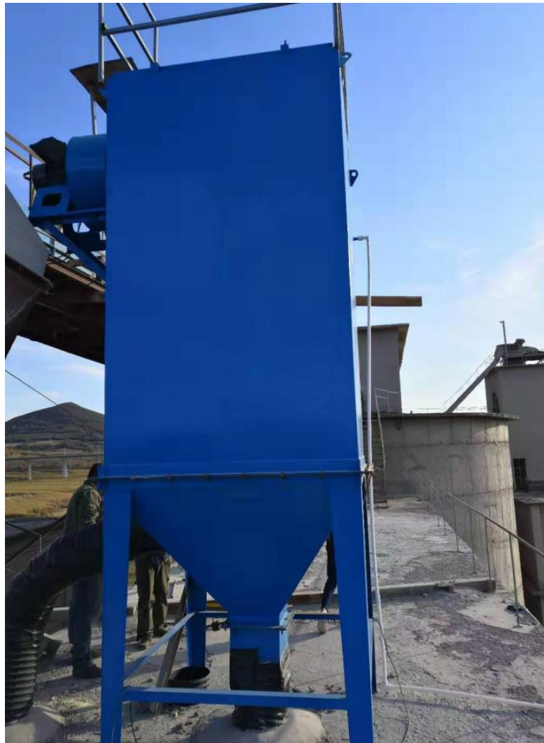
水泥仓除尘装置
