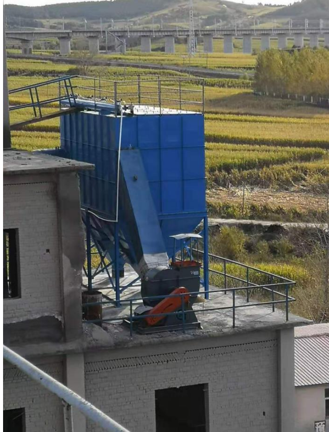
包装工段除尘装置
