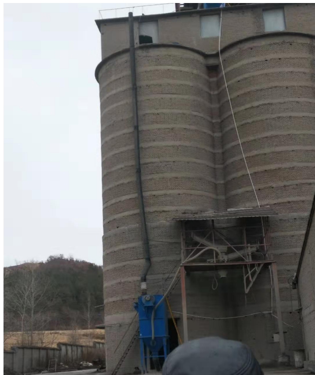
散装库处布袋除尘器及排气筒
