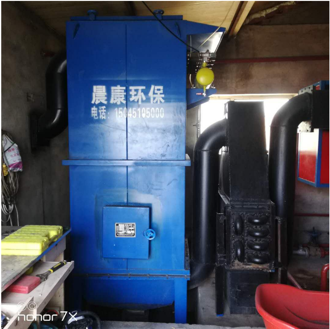
0.5t 锅炉及布袋除尘器
