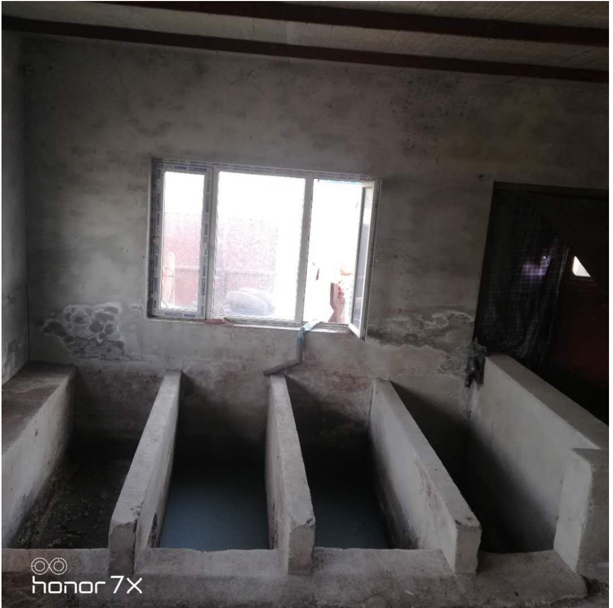
污水处理间处理设施
