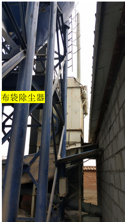
料仓处除尘装置
