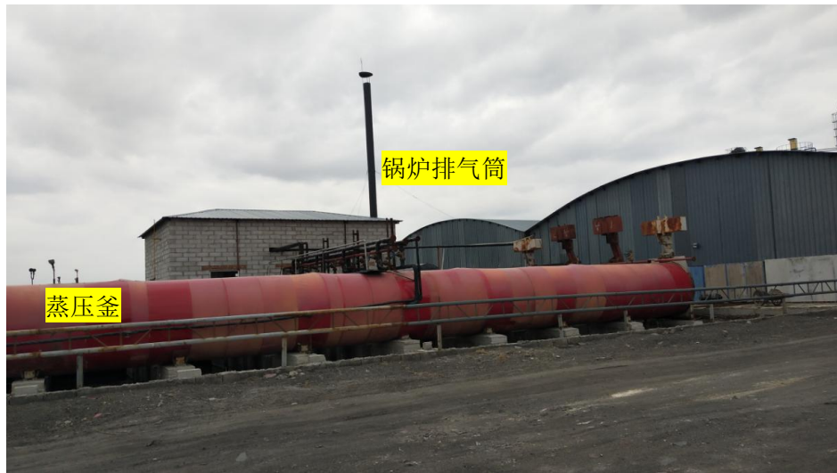
蒸压釜和锅炉房
